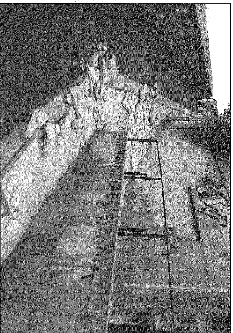
Es desconeix el motiu de les afectacions detectades en aquest punt del camí de la muralla descalçat. L'alcalde ha assegurat que el proper any es disposarà d'una partida pressupostària per arranjar aquell tram de camí de la muralla esfondrat.
