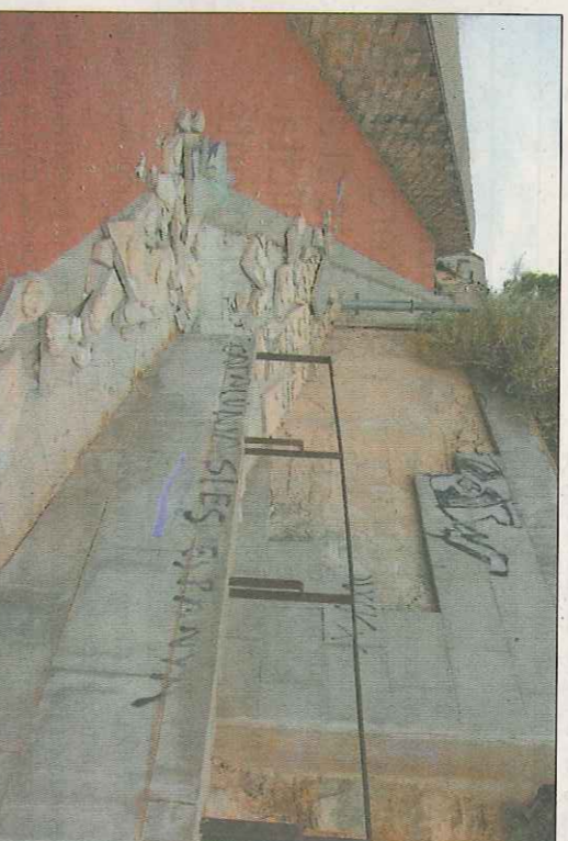
Imagen de los nuevos desperfectos detectados últimamente en el camino
